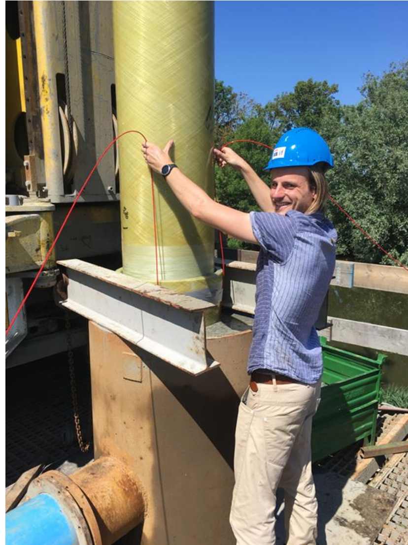
Composiet put, met glasvezel DTS kabel
