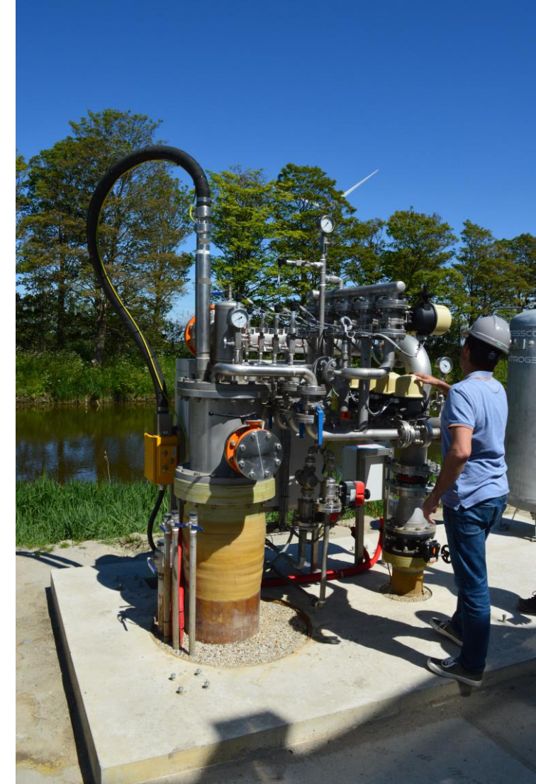
HT-bron met peilbuizen
